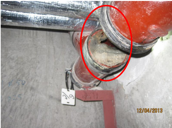
фановая труба забита строительным раствором
