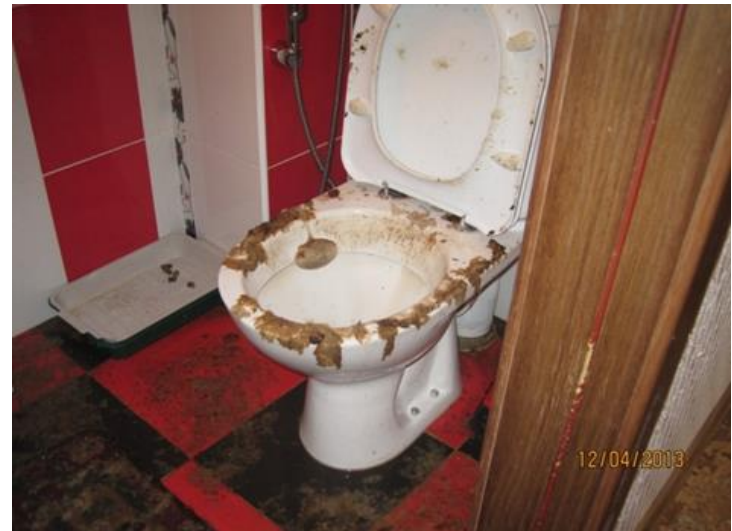
затопление квартиры фекальными массами после слива в унитаз строительных смесей
